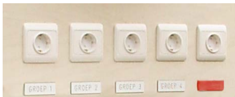
Figuur 16 Wandcontactdozen op de achterkant van de meterkast.
