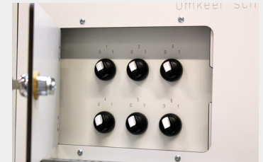
Foutenschakelaars achter afsluitbaar deurtje
